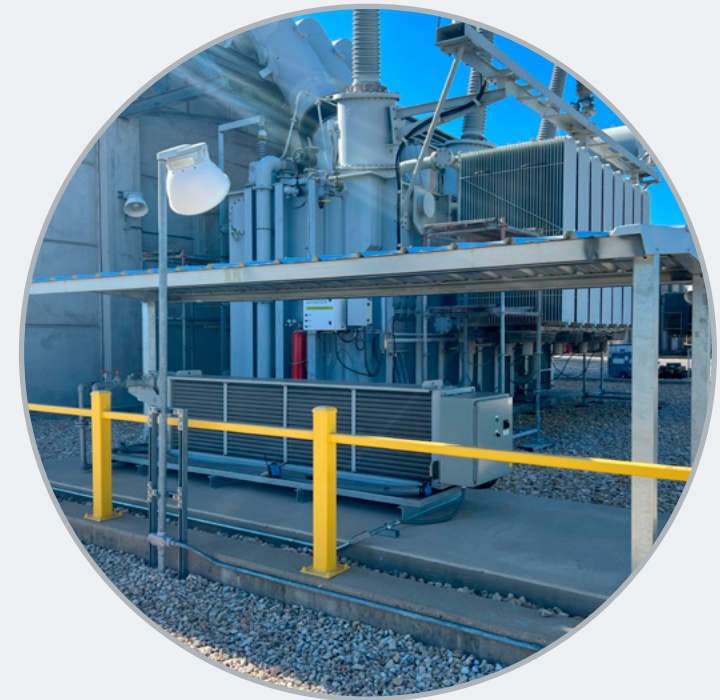
ระบบหล่อเย็นเสริมของหม้อแปลงไฟฟ้า (Auxiliary Transformer Cooler)
