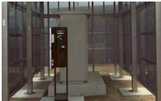
ระบบจ่ายไฟฉุกเฉินที่ BPPJP มอบให้แก่ชาวเมืองโอสึวากามัตสึ
